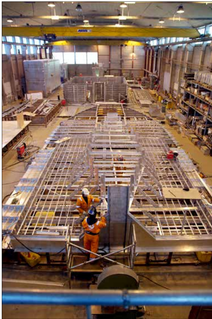
Nyskapnad: Verdas fyrste båtar av typen Wind server tek form i sveisehallen.
